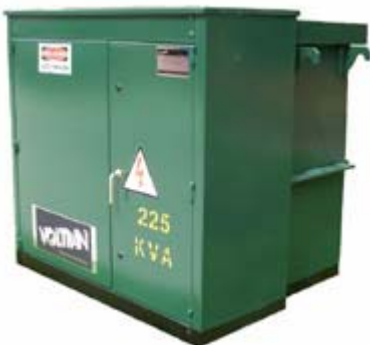
Figura 6. Transformado tipo pedestal.
